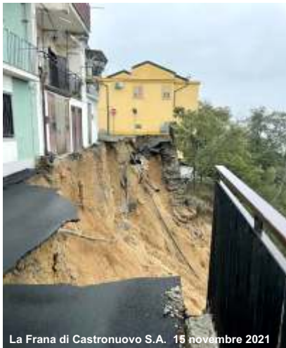
La Frana di Castronuovo S.A. 15 novembre 2021
